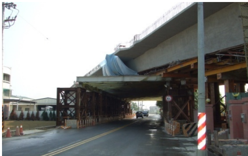
圖一 箱型預力梁局部挫屈 4K+086 事故處
