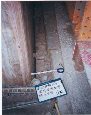
圖 三 橋墩與地表裂縫
