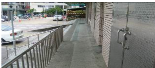
圖 7、引導通路有門把阻礙及通路過長，未設扶手
