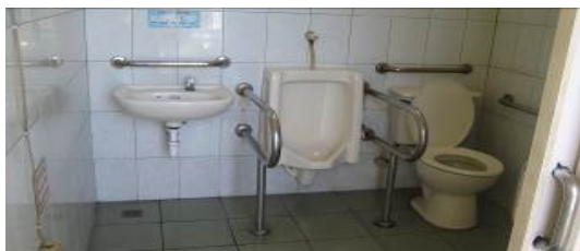
圖 1、廁所內迴轉空間不足
