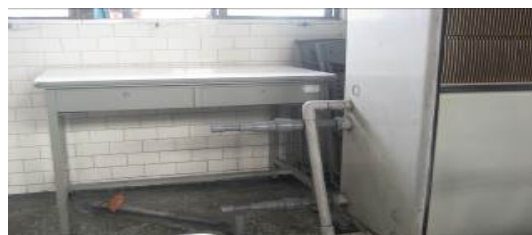
圖 8、室內通路堆放雜物，影響通行
