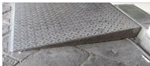
圖 4、進出口斜坡未符合坡度標準
