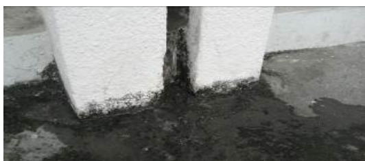
圖 11、引導通路有排水管，雨天嚴重積水
