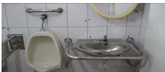
圖 9、廁所盥洗室迴轉空間不足
