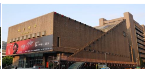
圖 3 外牆漏水、髒汙
