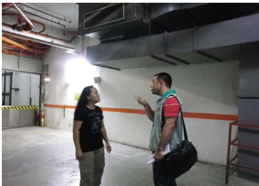
採用機械通風系統的地下室
