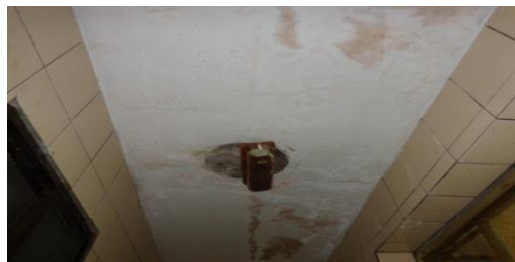
照片8 加蓋廁所天花板有水漬痕跡
