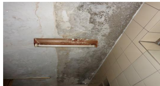
照片6 廚房之天花板油漆剝落
