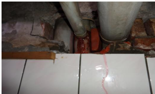
照片11 2樓浴廁排水管有顏料水滲出，磁磚也有水紋
