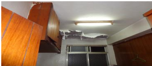
照片3 臥房2之天花板油漆鼓起剝落
