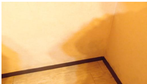
照片13 2樓套房1木作裝潢牆之貼皮出現水漬痕跡
