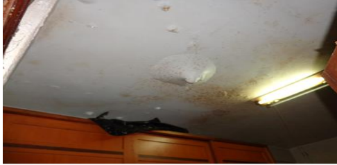
照片1 臥房1之天花板油漆鼓起，存在漏水之水滴
