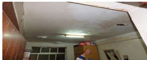
照片4 臥房3之天花板油漆鼓起剝落
