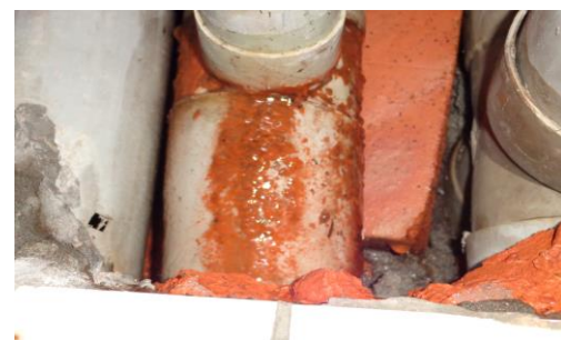
照片12 2樓浴廁排水管紅色顏料水滲出之放大
