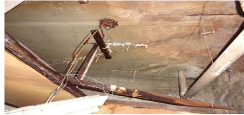
照片2 浴廁天花板裂縫及吐白
