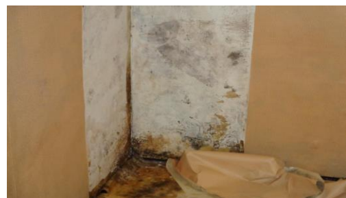
照片14 2樓臥房1木作裝潢牆之貼皮剝落
